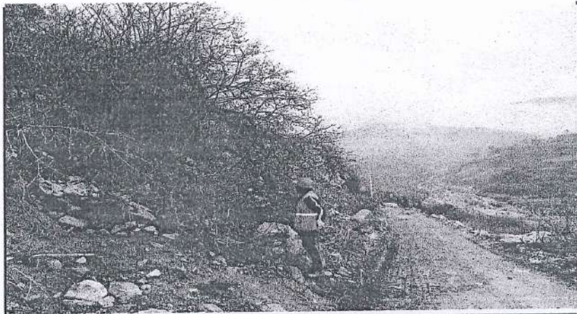
SE OBSERVA LOS TRABAJOS DE LIMPIEZA GENERAL ROCE Y DESBROCE EN EL Km 2+100
